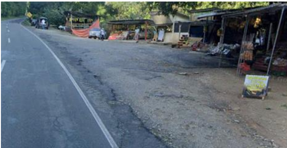
Foto 101 – Asfalto deteriorado na área de comércio ao longo da rodovia.
