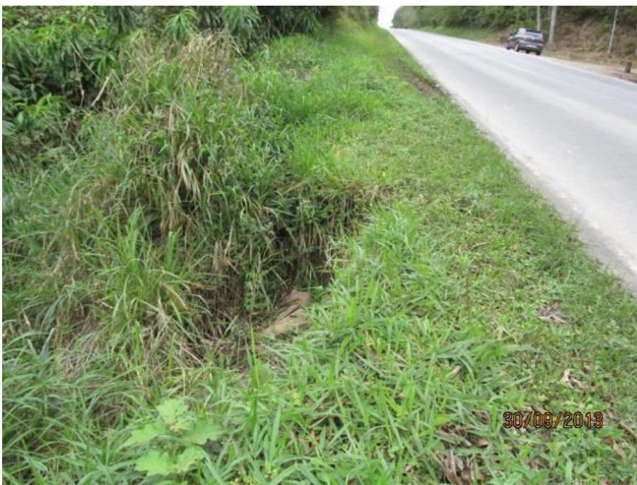
Foto 133 – Km 20+000 – Vista do trecho (LE), apresentando início de processo erosivo
