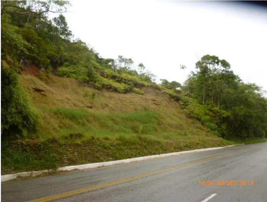
Foto 132 – Km 4+900 – Vista do trecho (LE), apresentando processo erosivo
