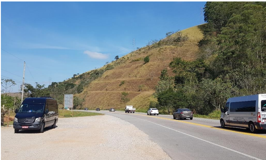
Foto 128 – Talude junto a Rodovia SP-123
