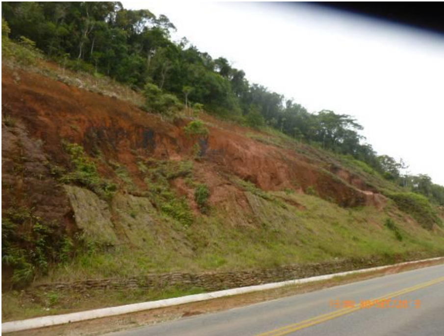
Foto 134 – Km 27+000 – Vista do trecho (LE), apresentando processo erosivo
