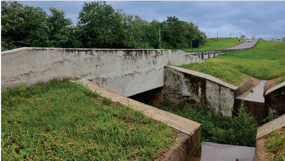
Figura 8.4: Necessidade de proteção dos usuários em estrutura de drenagem não traspassável
