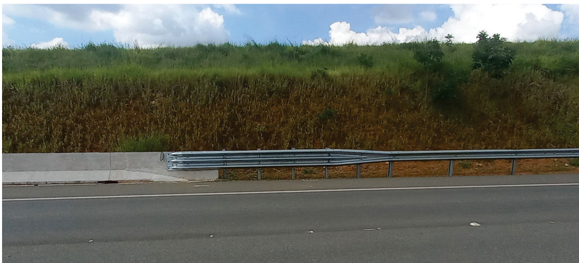
Figura 8.8: Exemplo de uso de dispositivo de contenção lateral em uma ponte
