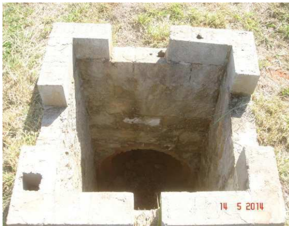
Ausência de Grelha na Caixa Construída
