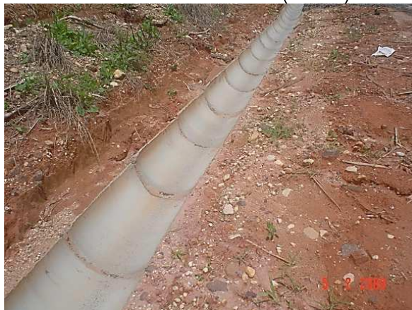
Canaleta Mal Executada (Juntas)
