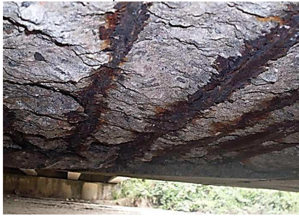
Armadura Exposta / Armadura Corroída
