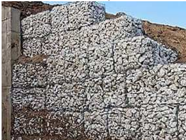
Gabiões – Perda de Finos, Desalinhamento
