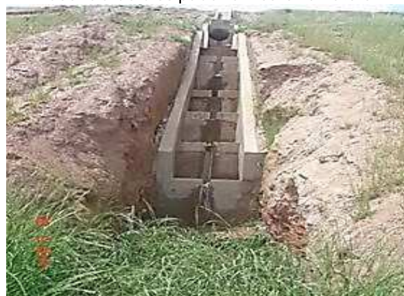
Ausência de dissipador e Reaterro Lateral
