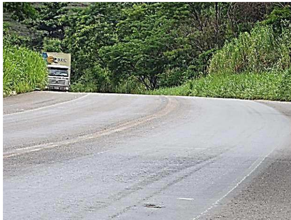
Falha em Pintura Horizontal – Perda de Visibilidade
