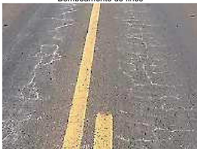
Bombeamento de finos
