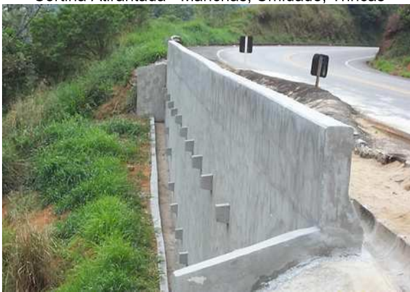
Cortina Atirantada - Manchas, Umidade, Trincas
