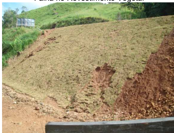
Falha no Revestimento Vegetal
