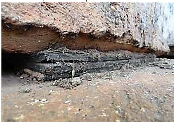
Aparelho de Apoio Danificado
