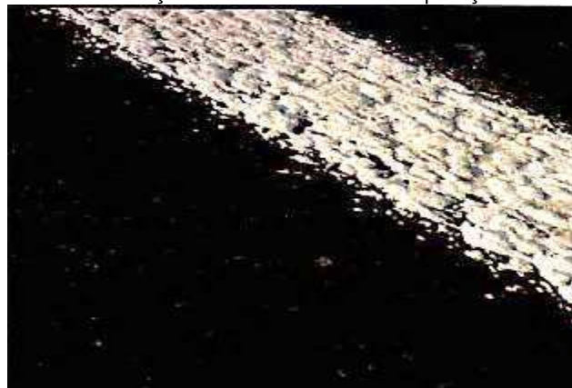
Sinalização Horizontal – Falha de Aplicação
