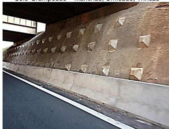
Solo-Grampeado – Manchas, Umidade, Trincas
