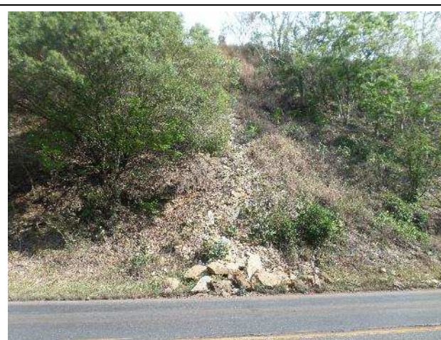
Foto 30: Escorregamento de rochas – km 209+200.
