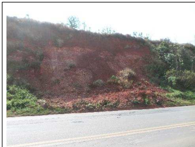
Foto 29: Escorregamento de talude – km 174+050.
