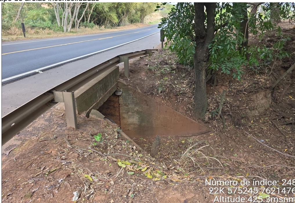
Foto 3 - Estrutura de drenagem sob a Rodovia SP-425, implantada em área da Formação Vale do Rio do Peixe, composta por arenitos da Bacia do Paraná. Observa-se solo derivado de rocha sedimentar, de textura arenosa, suscetível a processos erosivos.
