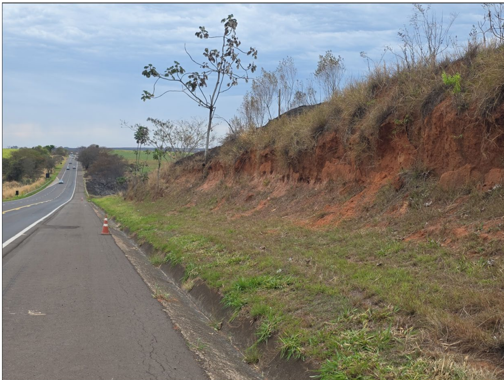
Foto 1 – Talude de corte na Rodovia SP-425, com exposição de solos avermelhados típicos da Bacia do Paraná (Latossolos e Argissolos), suscetíveis à erosão em áreas de declive
