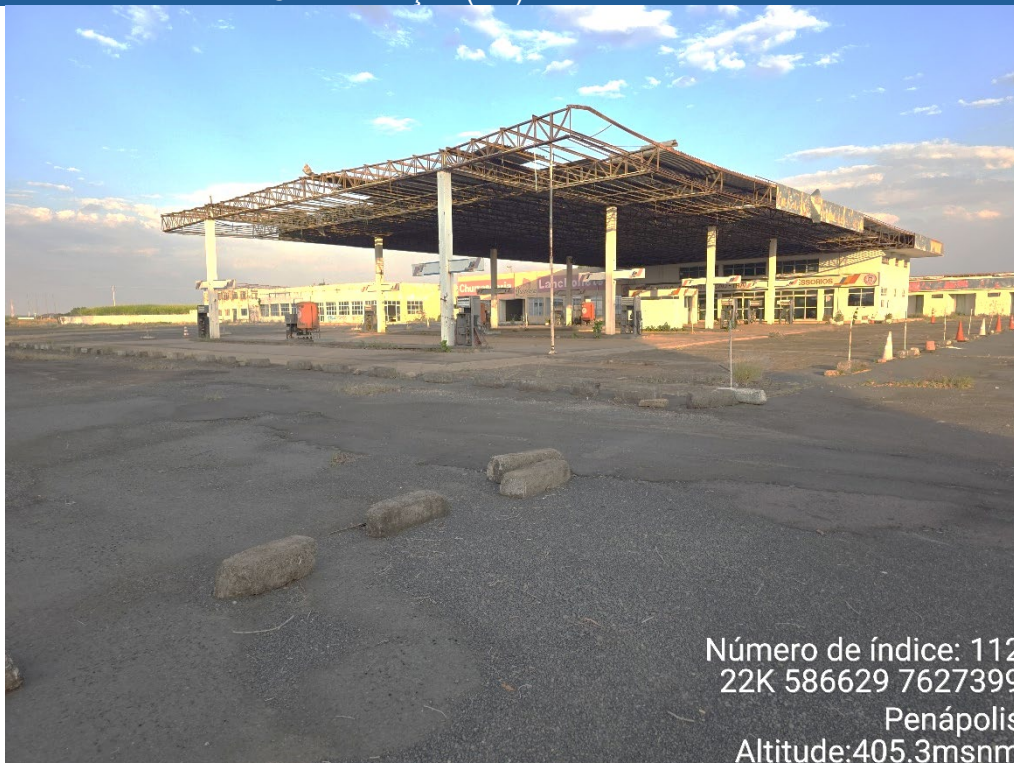
Foto 10 - Km 295+300 – LE – Ponto de Gasolina Abandonado.
