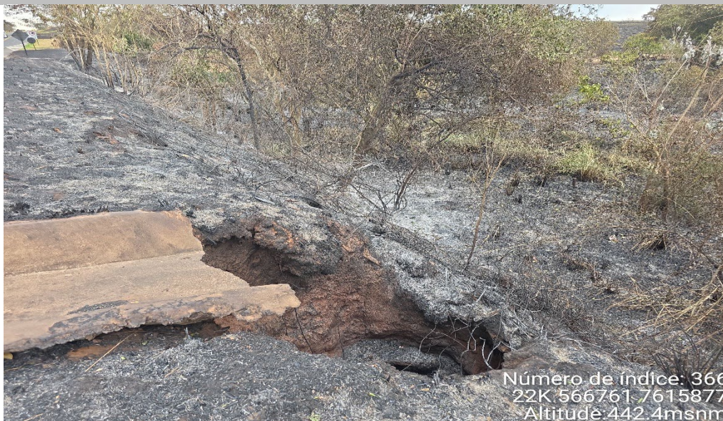
Foto 16 - Km 314+900 – LD – Deflagração de Processos Erosivos em área contígua a drenagem em talude de aterro e solapamento do dispositivo de drenagem.
