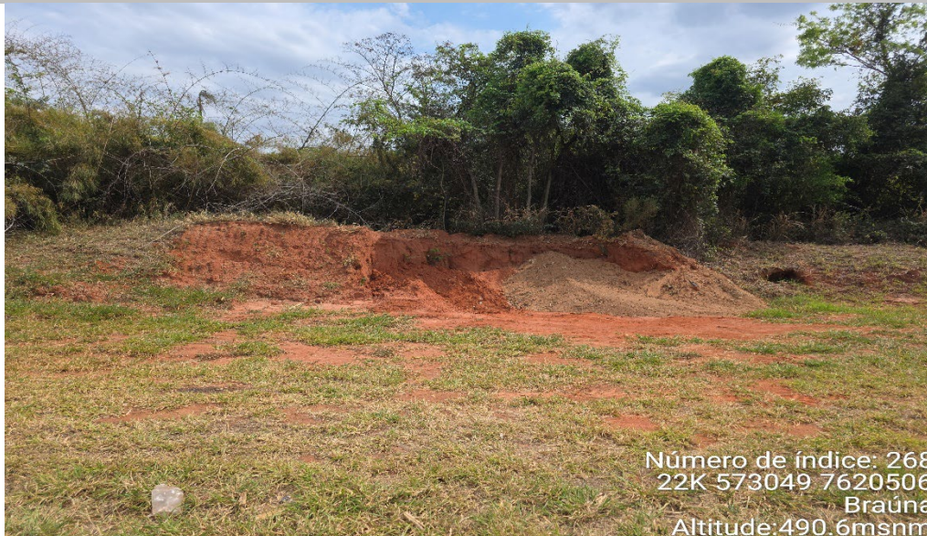
Foto 13 - Km 311+100 – LD – Caixa de Empréstimo na faixa de domínio sem a devida recuperação (retaludamento e implantação e cobertura vegetal).
